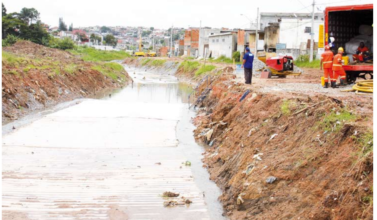
O córrego Três Pontes, na Cidade Kemel, em Ferraz de Vasconcelos, terá um trecho de aproximadamente 800 metros canalizado
